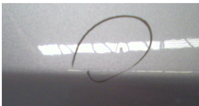
Figura 5 – Exemplo do Defeito Sujidade
